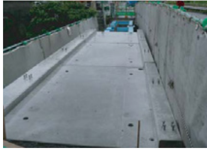
既設桁等の補修を実施後、ダクトアルスラブ 6 枚敷設 (参考重量：2731kg/ 枚)
